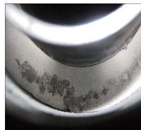
图5 水泥环破坏微环隙界面
